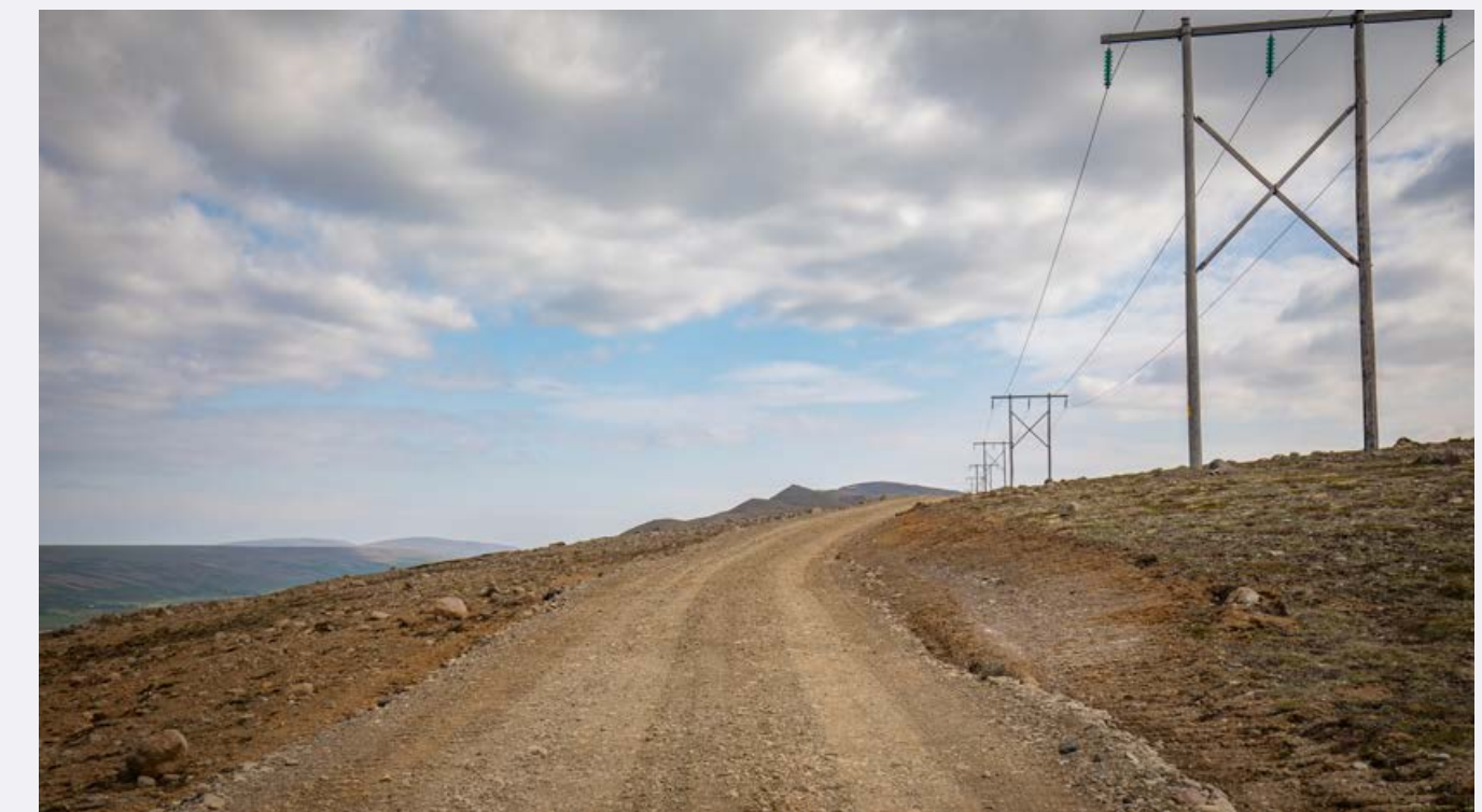
Dæmi 4. Nýleg línuslóð vegna Hólasandslínu 3
